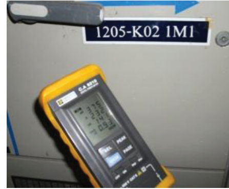
(ข) กำลังไฟฟ้าขณะทำงาน 141 kW
