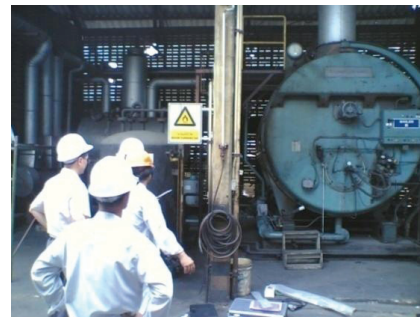
รูปที่ 19.2 (ก) หม้อไอน้ำขนาด 6 Ton (ก่อนปรับปรุง)
