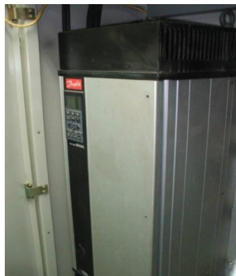
รูปที่ 12.3 การติดตั้ง VSD อยู่บริเวณตู้ควบคุม เครื่องสูบน้ำหล่อเย็น
