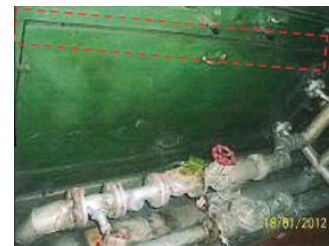
รูปที่ 18.1 ท่อไอน้ำบางส่วนไม่ได้หุ้มฉนวนและผนังประตูมีลมร้อนรั่วไหลออก
