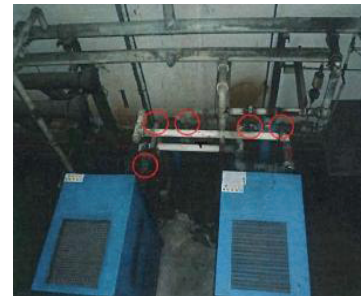
รูปที่ 16.1 จุดที่ตรวจสอบพบลมรั่วในกระบวนการผลิต
