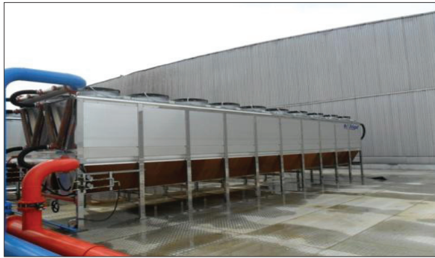
รูปที่ 13.3 Cooling Tower ระบบปิด ที่ติดตั้งใช้งานแทนแบบเดิม
