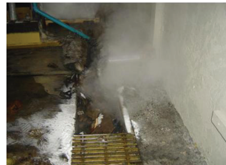
รูปที่ 17.2 การรั่วไหลของไอน้ำบริเวณ Plant Liquid SHMP (L-SHMP)
